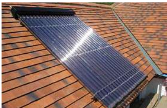
Zespół kolektorów słonecznych zamontowany na dachu budynku
